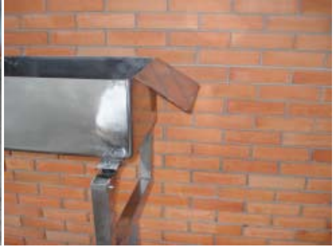
Rampa de acesso para evitar lesões.
