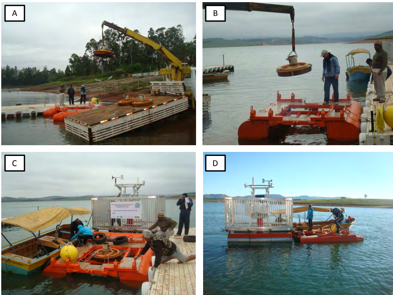
Figura 4 A a D: A e B – carregamento de rodas de trem no flutuante (lançador) para servir de poitas para as Plataformas fundeadas. C e D – transporte da Plataforma Principal e do lançador com uso de embarcações até o local de fundeio.
