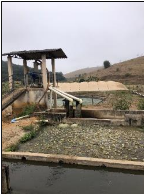
Figura 7 - Biorreator Lagoa Coberta
