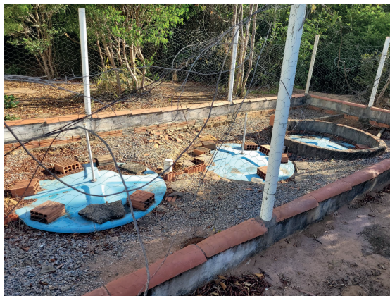
Figura 4 - Sistema de Tratamento de Esgoto.
