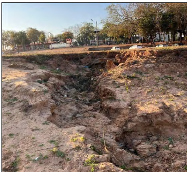
Figura 3. Processo erosivo na margem da galeria pluvial.
