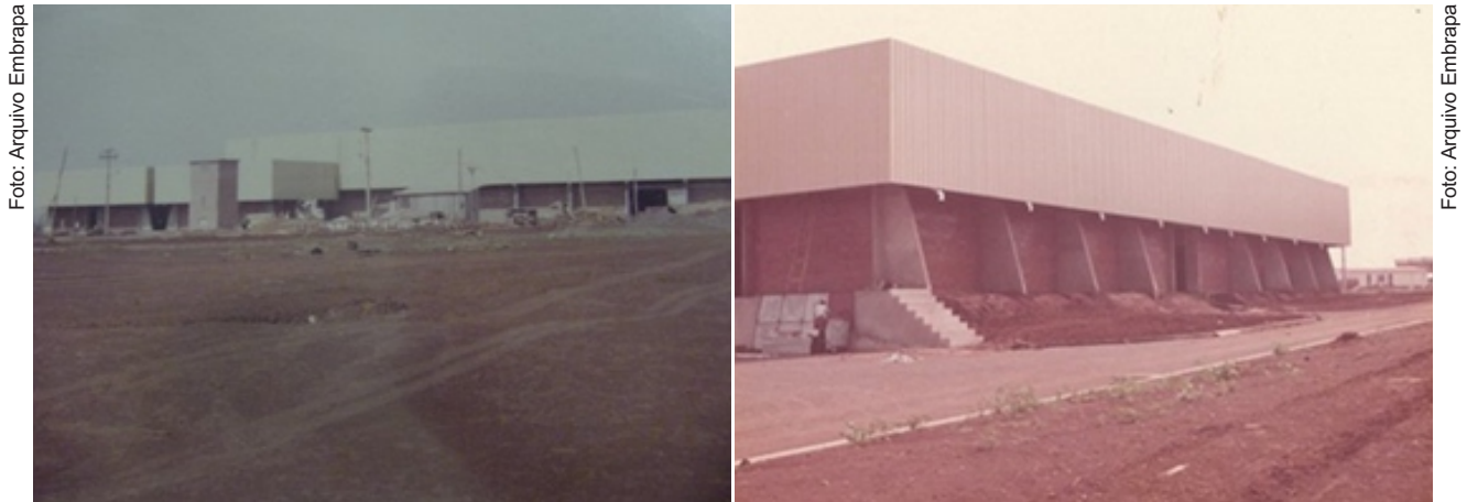
Figura 8. Vista parcial da construção da Unidade de Beneficiamento de Sementes do Serviço de Produção de Sementes Básicas da Embrapa, em Dourados, MS.
