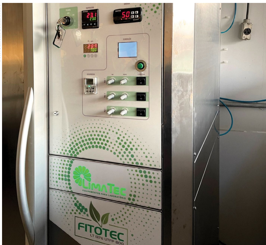
Figura 24.1. Câmara climática tipo Fitotron instalada na Embrapa Meio Ambiente.
