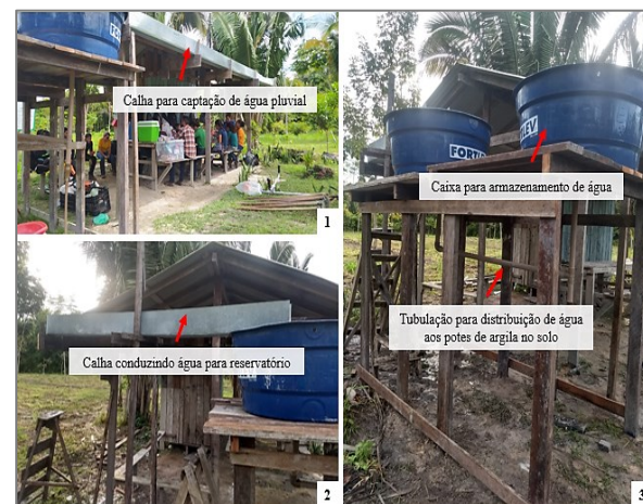
Figura 3. Aspectos do sistema IrrigaPote, replicado na Fazenda Experimental da UFOPA, Santarém, Pará. 1. Calha para captação de água pluvial; 2. Calha conduzindo água para o reservatório; e 3. Sistema composto pela caixa d'água e a tubulação para a distribuição de água aos potes de argila no solo. Fonte: Autores (2023).
