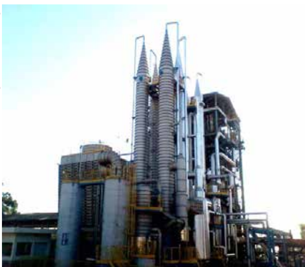
Figura 10.22. Visão geral do concentrador de vinhaça com integração energética (Araraquara, SP).
