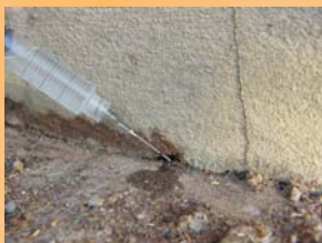
Fig. 13. Aplicação de inseticida em túneis com saída de cupins diretamente na parede.
